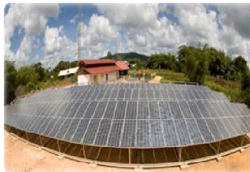
Centrale en site isolé à Kaw @R.Lietard
