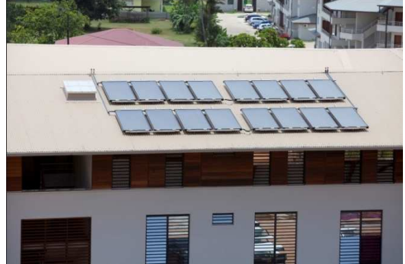
Production centralisée d'eau chaude solaire pour des logements collectifs en Guyane.
